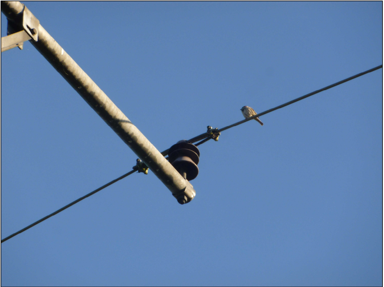
Abb. 2: Feldsperling am Brutplatz im Querrohr der Mittelspannungslitung
